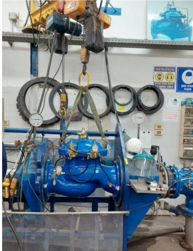
Figura 28. Válvula ensayada con bajos caudales
