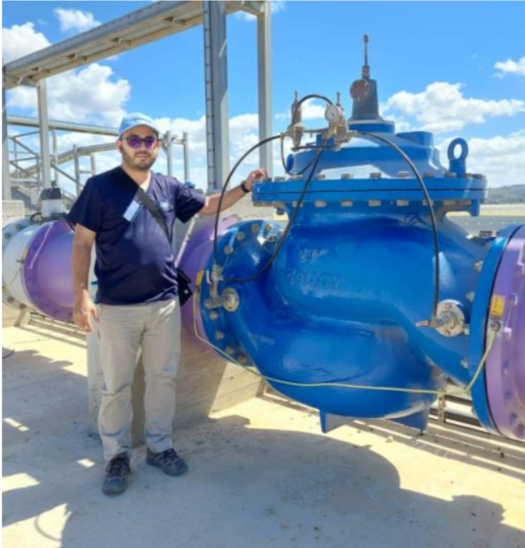
Figura 18. Válvula sostenedora de presión de 600mm de diámetro.
