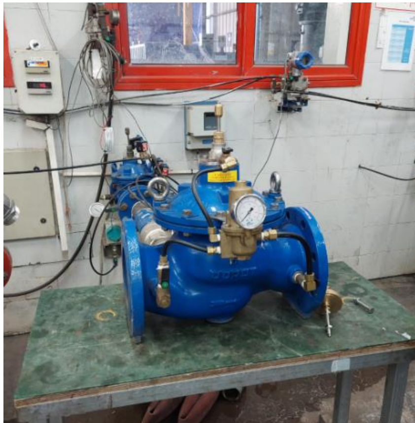
Figura 27. Válvula reductora de presión terminada
