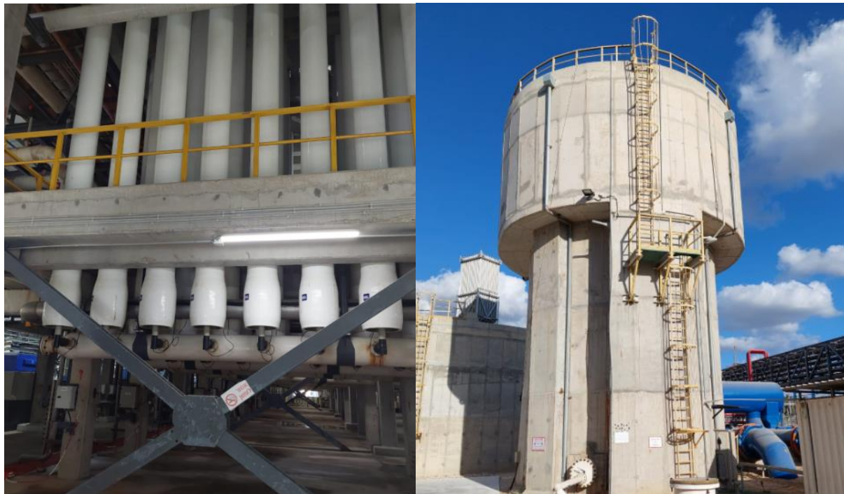
Figura 23. Instalaciones de la planta SOREK filtros y tanque
