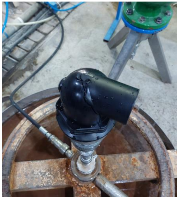
Figura 13. Válvula de aire luego de prueba destructiva
