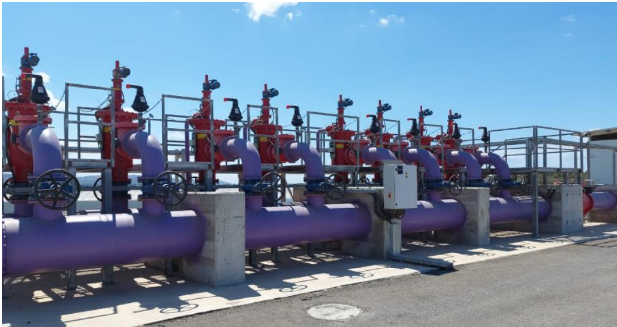
Figura 17. Estación de bombeo de agua residual
