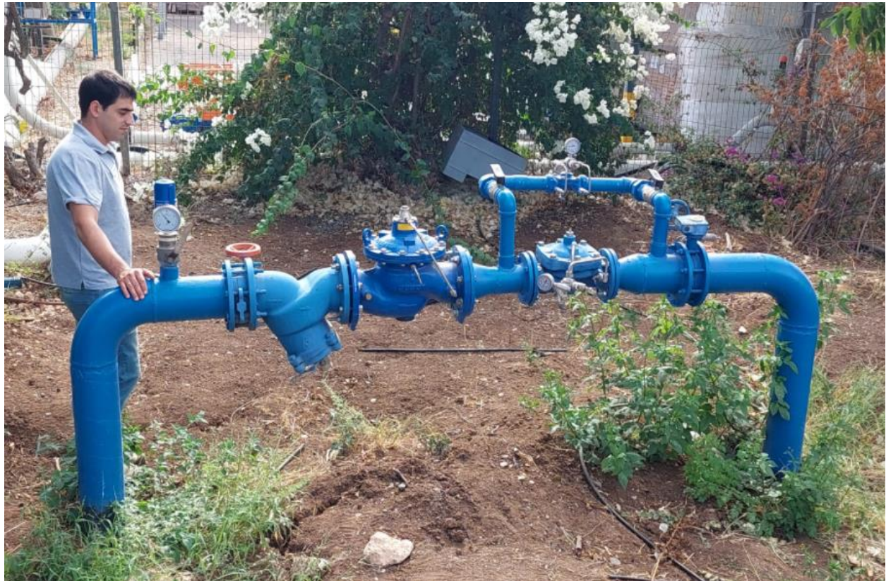
Figura 14. Configuración de válvula de control hidráulico reductora de presión con válvula proporcional.
